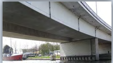
R30 brug in Brugge na melding Pont R30 à Bruges après le signalement
